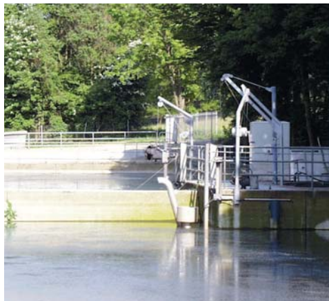
Depuración de aguas residuales comunales
